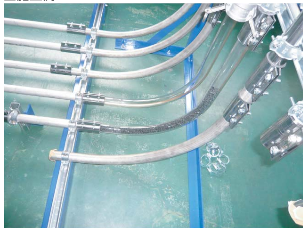
両端は配管ジョイントで固定
